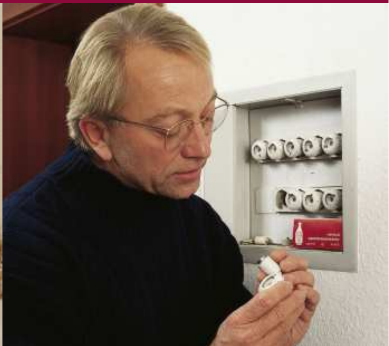
Auslösende Sicherungen deuten auf eine Überlastung des Stromkreises.
